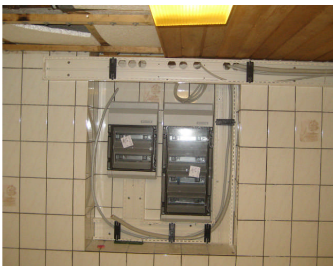
Neue Verteilung im Technikraum
